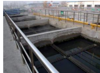
(f) 污水处理池
